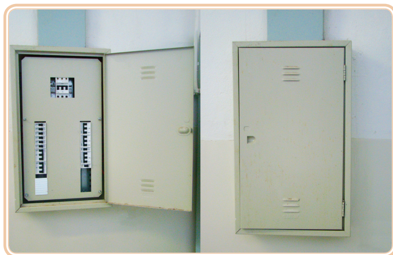
Figura 4.7: Quadro de distribuição com seus disjuntores
